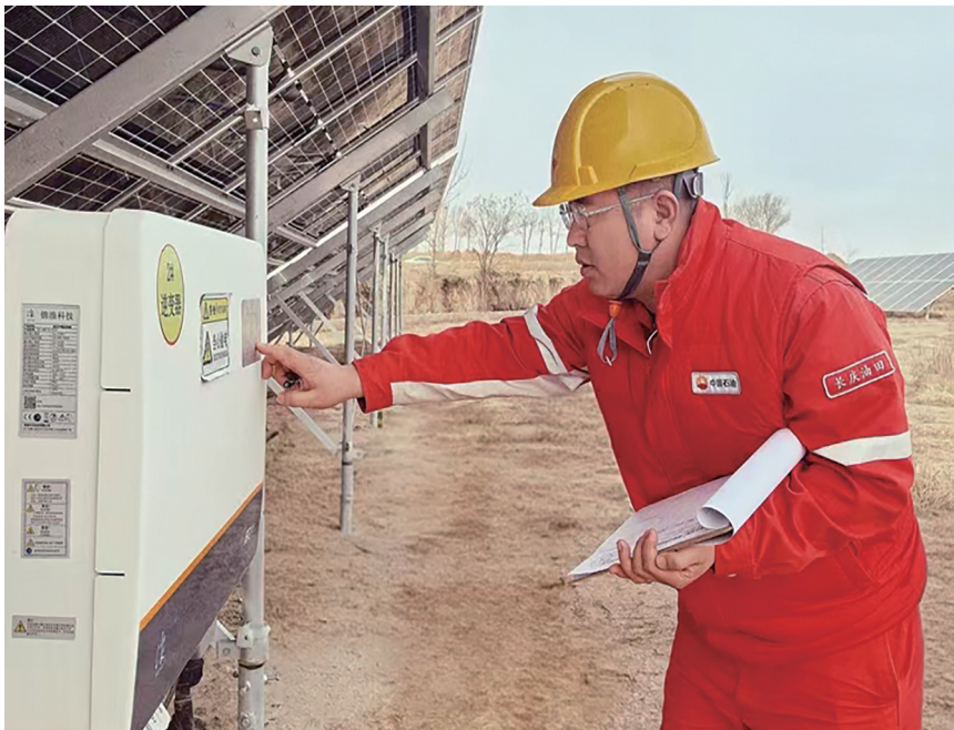
工作人员日常巡视检查光伏设备 赵君 摄
